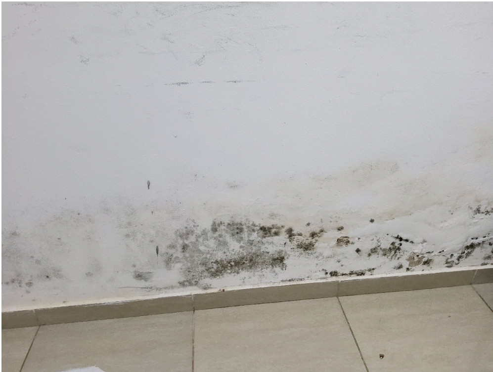
Parede com infiltração
