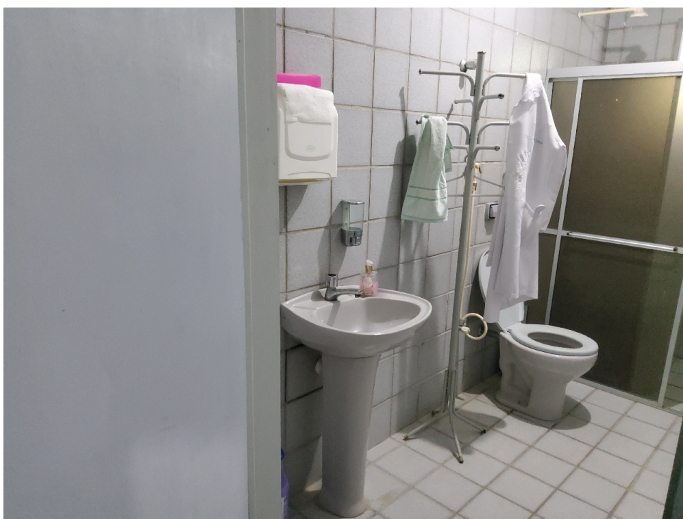
Item não conforme: 1 pia ou lavabo
