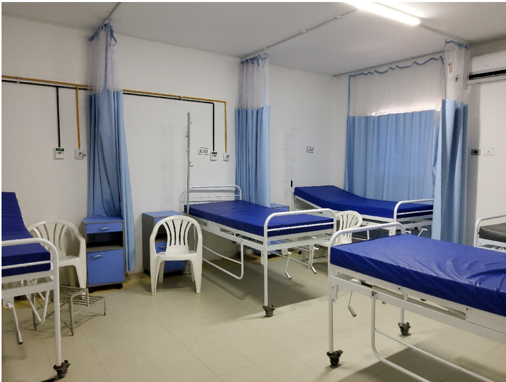
Enfermaria cirúrgica climatizada
