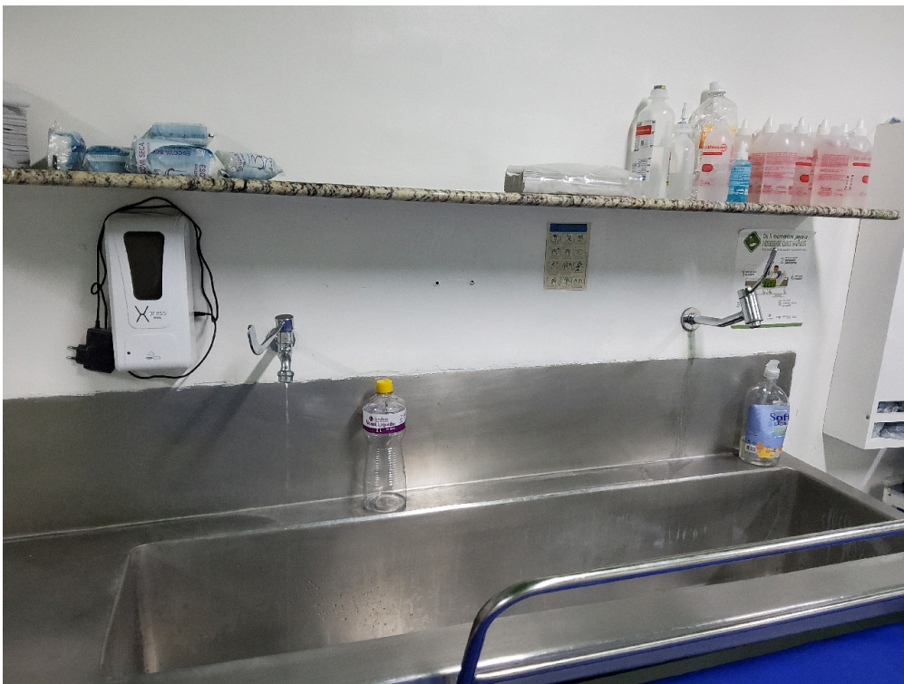
Centro cirúrgico obstétrico
