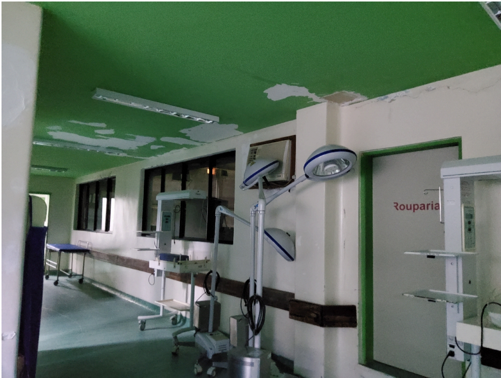
Centro cirúrgico obstétrico
