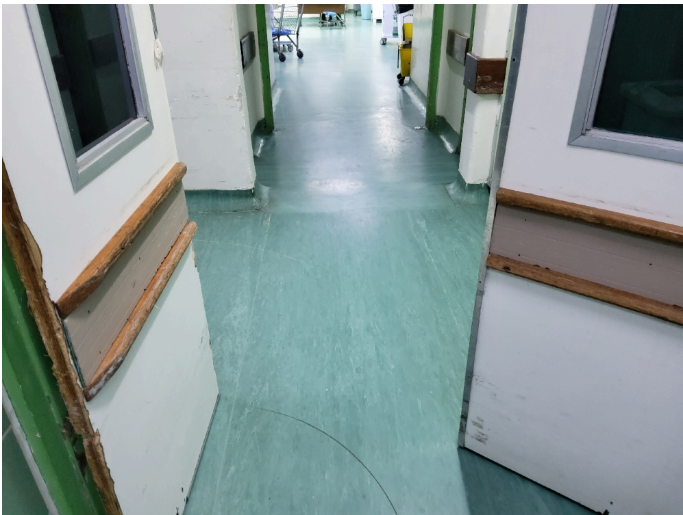
Centro cirúrgico obstétrico
