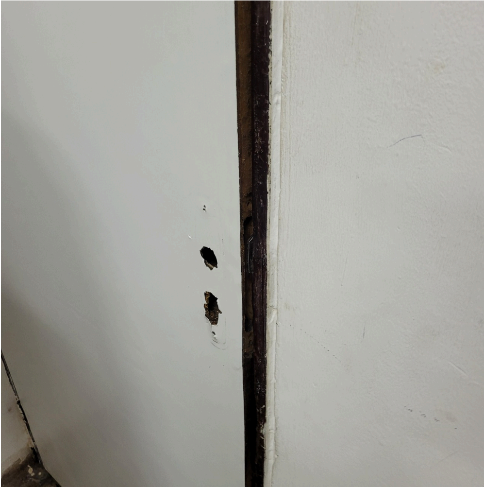
Porta sem fechadura em consultório na emergência de clínica médica - imagem 03
