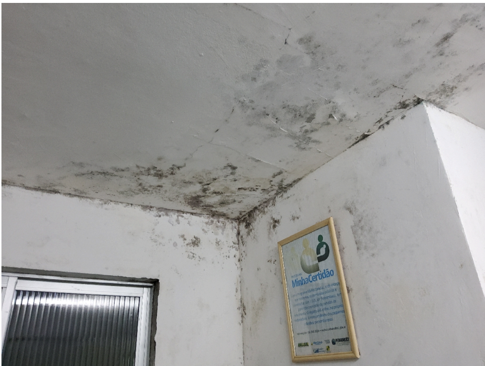
Infiltração no teto
