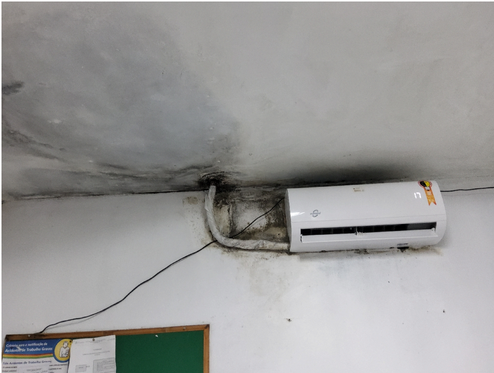
Ar condicionado da sala de cirurgia
