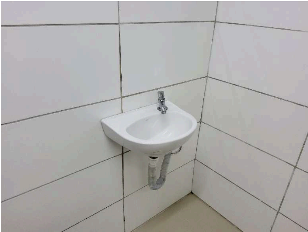
Item não conforme: Toalhas de papel
