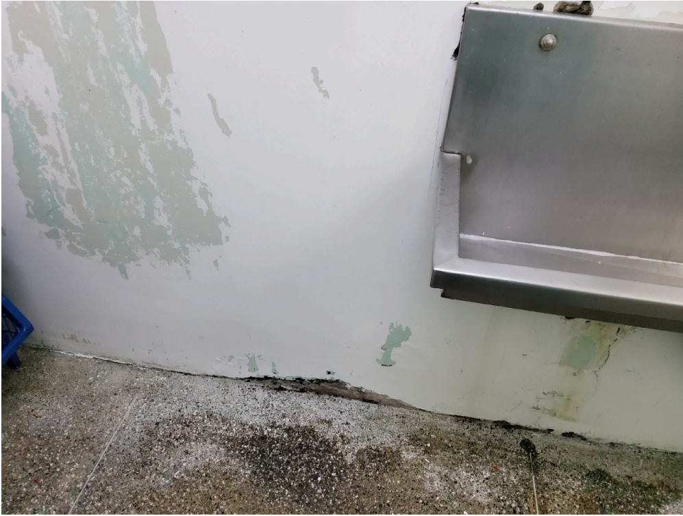
Item não conforme: Local adequado para higienização das mãos
