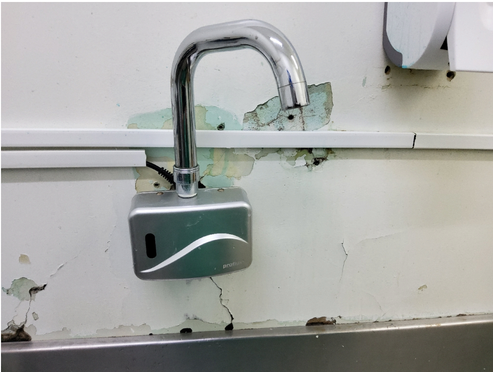
Item não conforme: Torneiras com abertura sem contato manual
