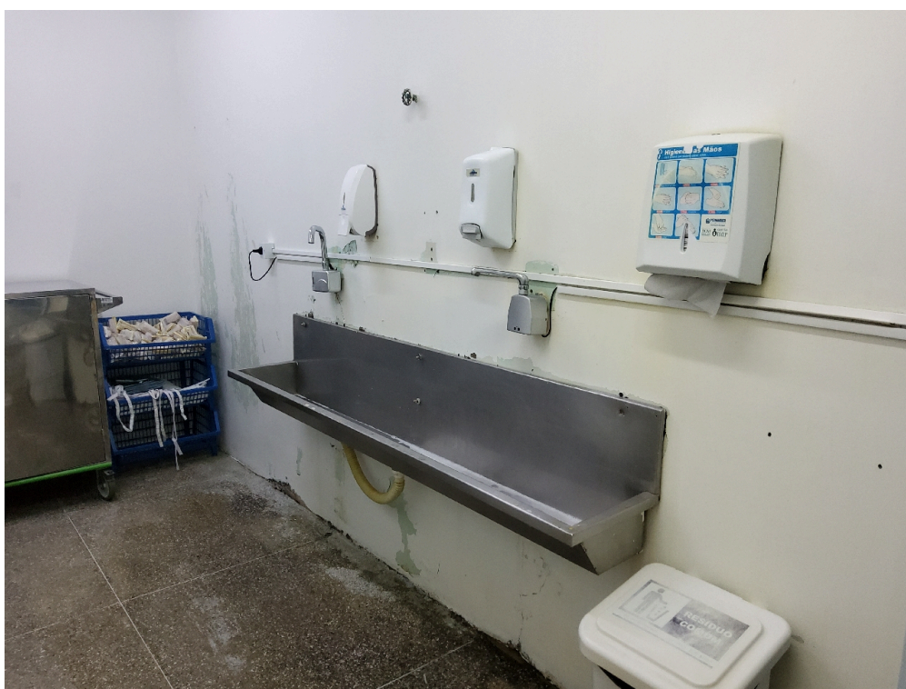
Item não conforme: Local adequado para higienização das mãos
