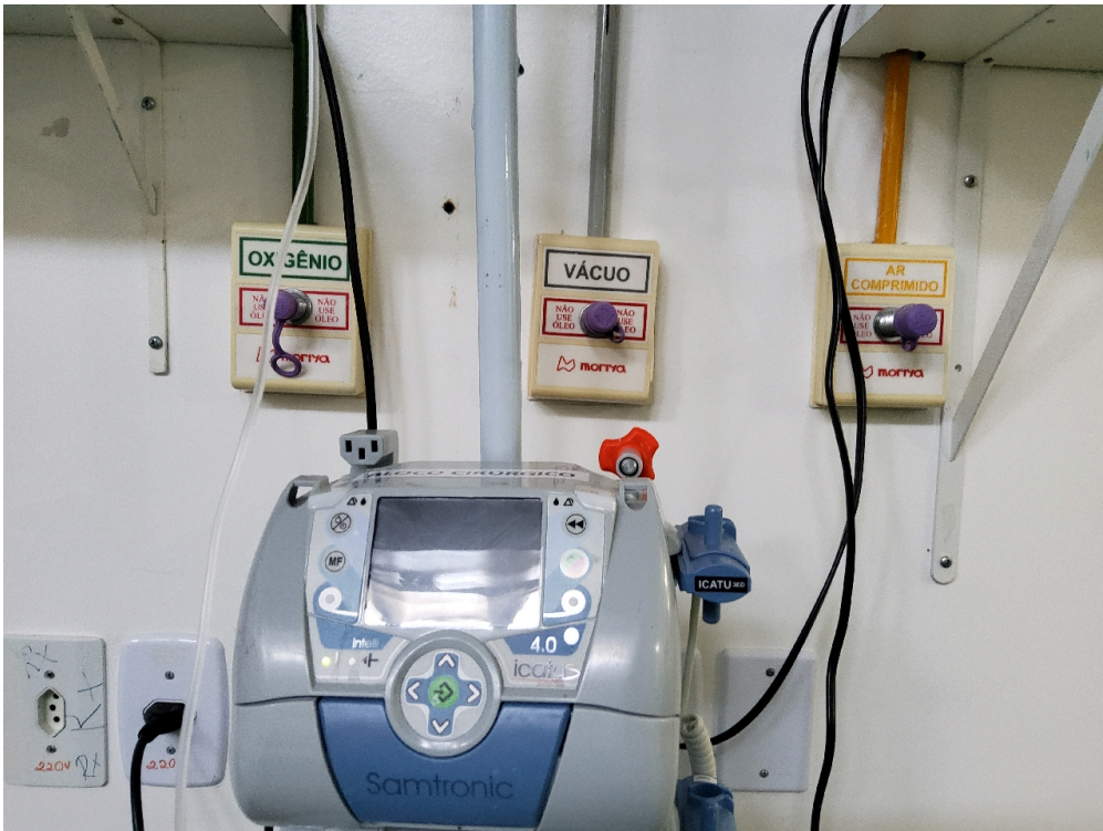
Rede fixa de ar comprimido
