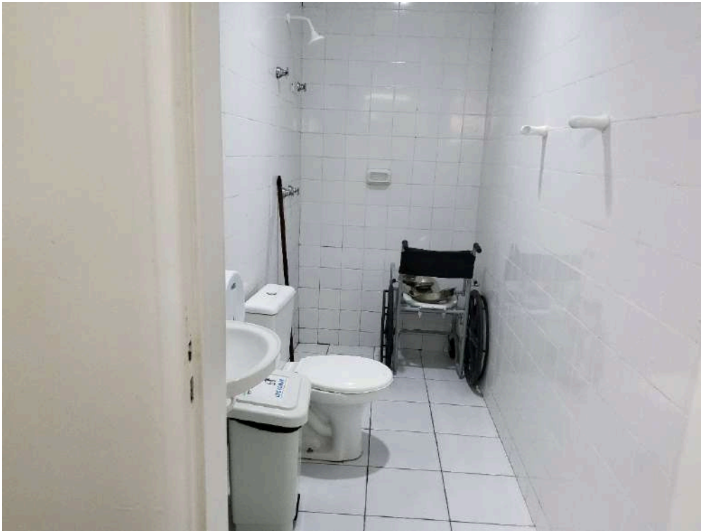
Sanitário para portador de necessidades especiais
