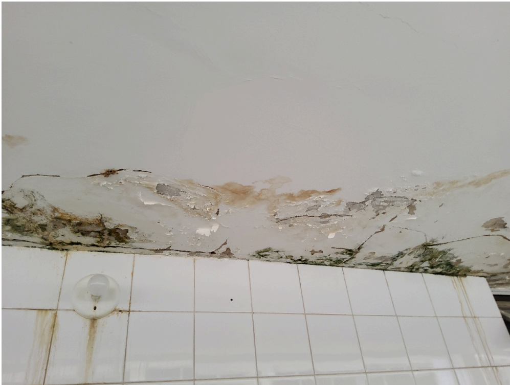
Teto com infiltração
