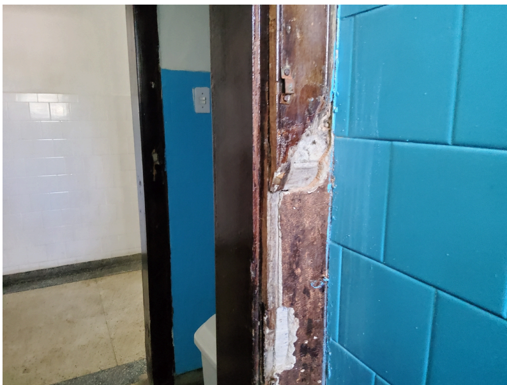
Infraestrutura precária (foto 2)
