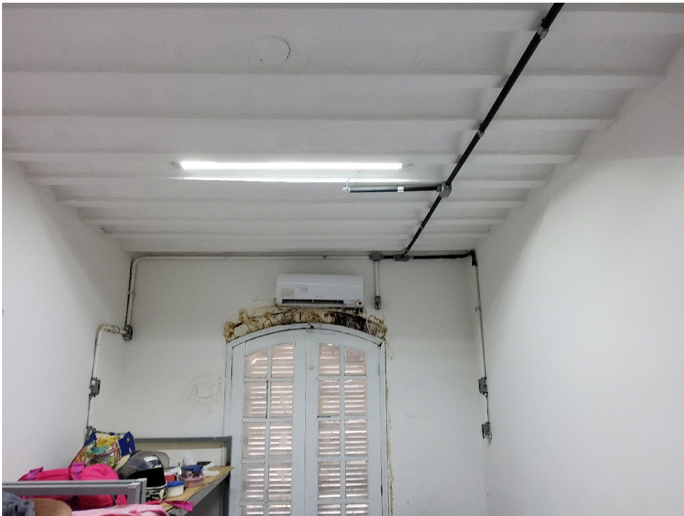
Infiltração repouso nível médio
