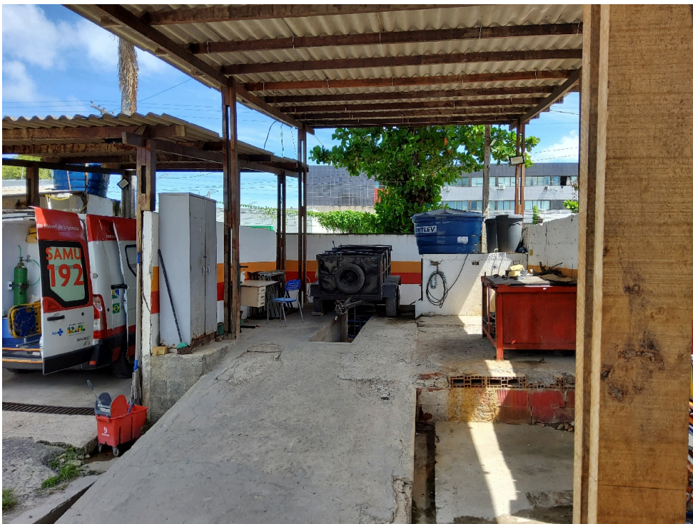
Dique para lavagem das ambulâncias
