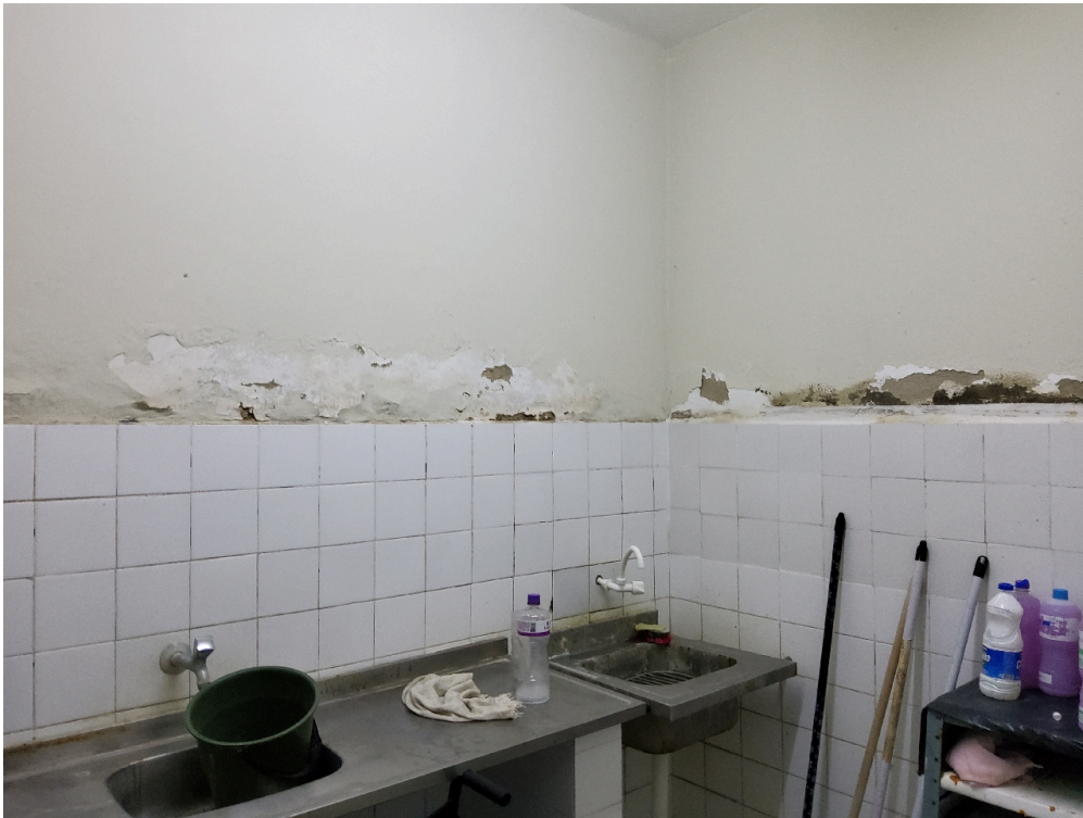
Expurgo com reboco caindo
