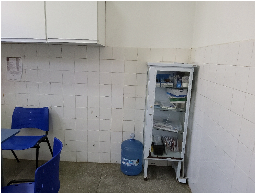
Sala de triagem (foto 2) observar ausência de pia
