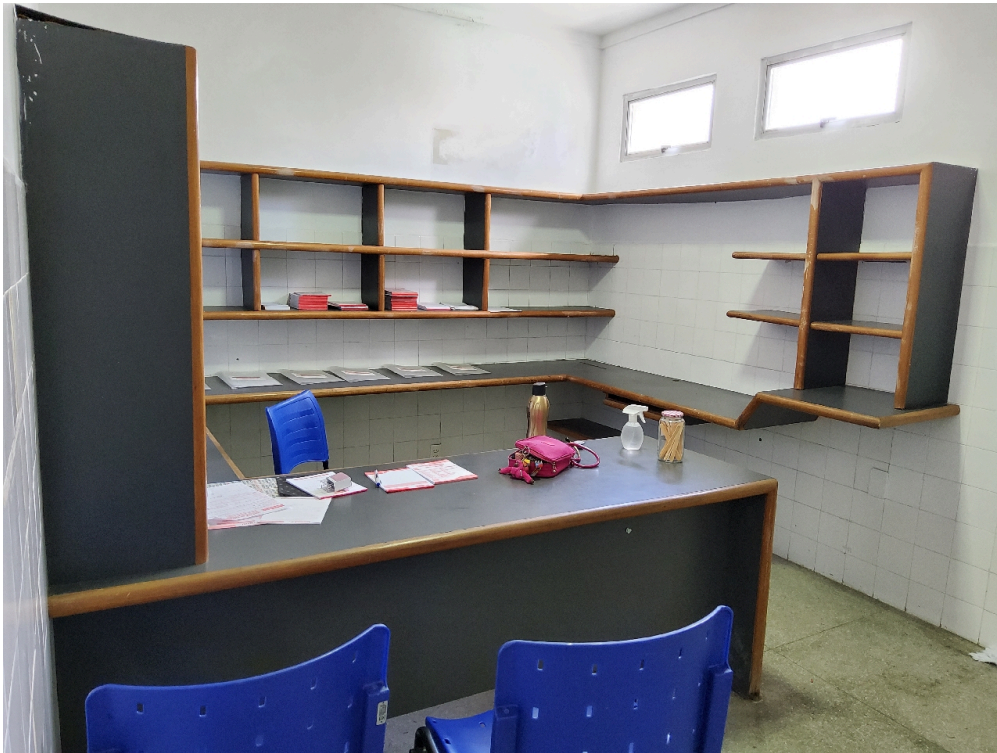
Consultório médico (foto 1) observar ausência de pia
