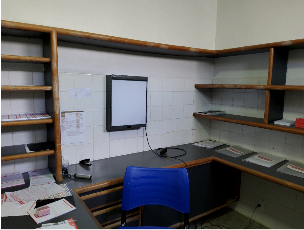
Consultório médico (foto 3) observar ausência de pia
