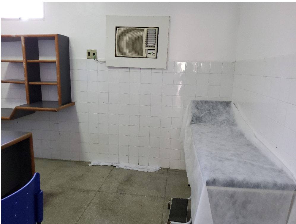
Consultório médico (foto 2) observar ausência de pia
