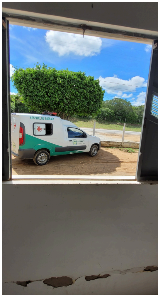
ambulância básica da unidade e janela sem tela. não há telas nas janelas da unidade, inclusive na copa
