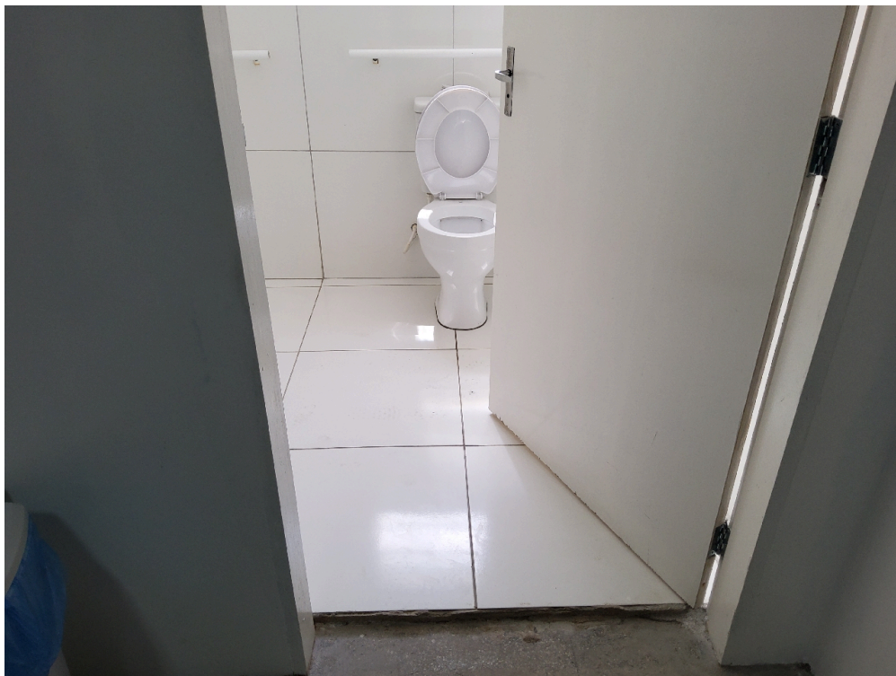
Banheiro de acessibilidade com obstáculo na entrada
