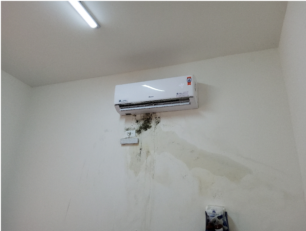
Infiltração parede do consultório 1
