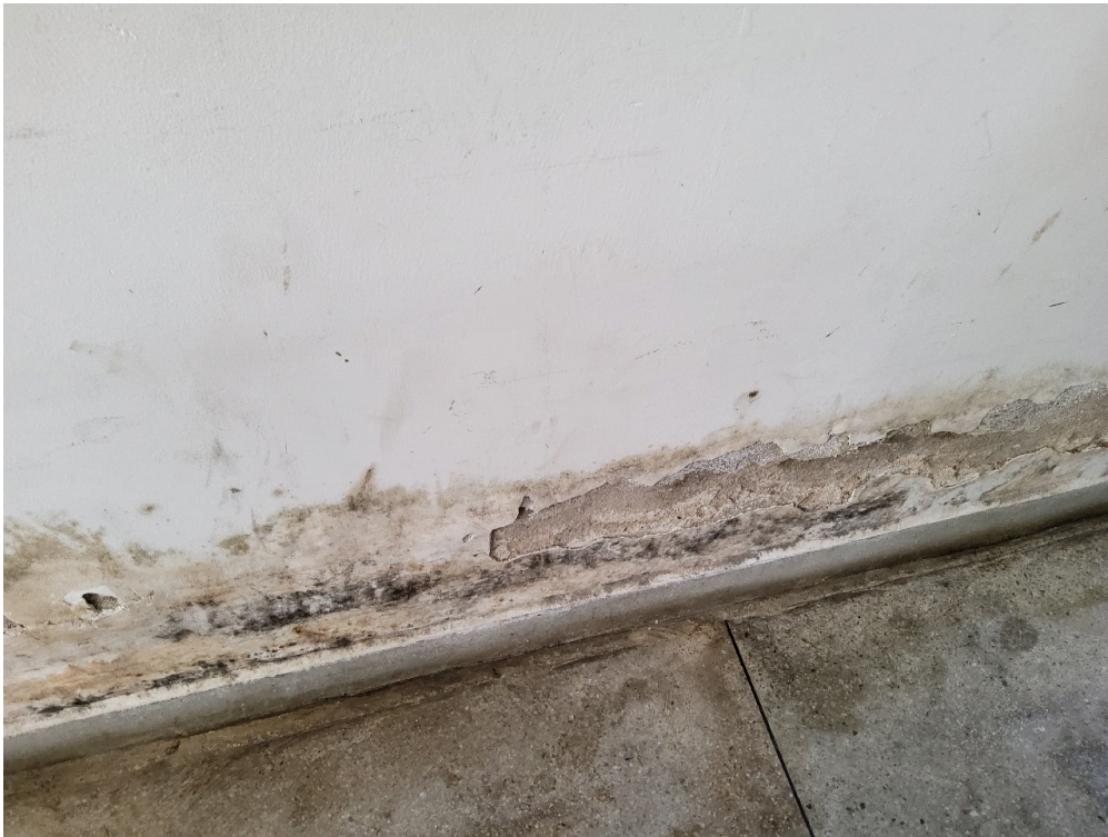
Infiltração na sala de observação pediátrica
