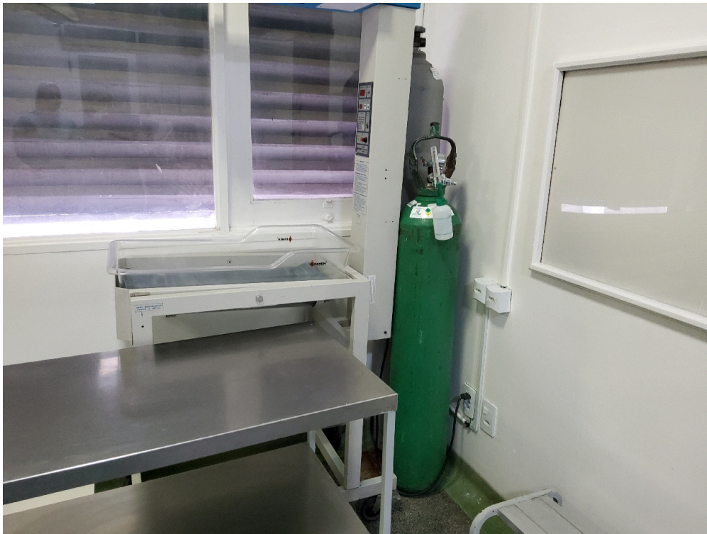
Cilindro de oxigênio sem fixação
