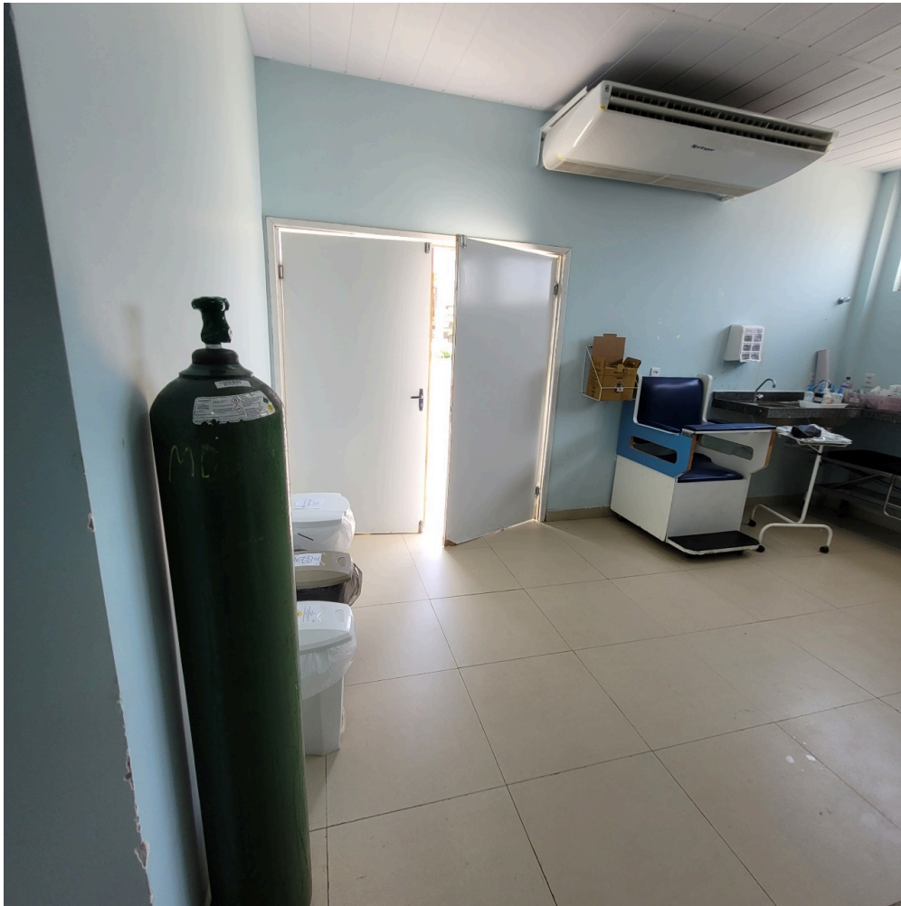
cilindro de oxigênio da sala vermelha sem fixação
