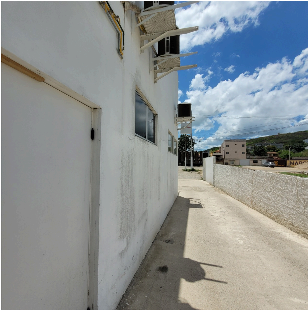
corredor de acesso da ambulância a porta da sala vermelha sem cobertura
