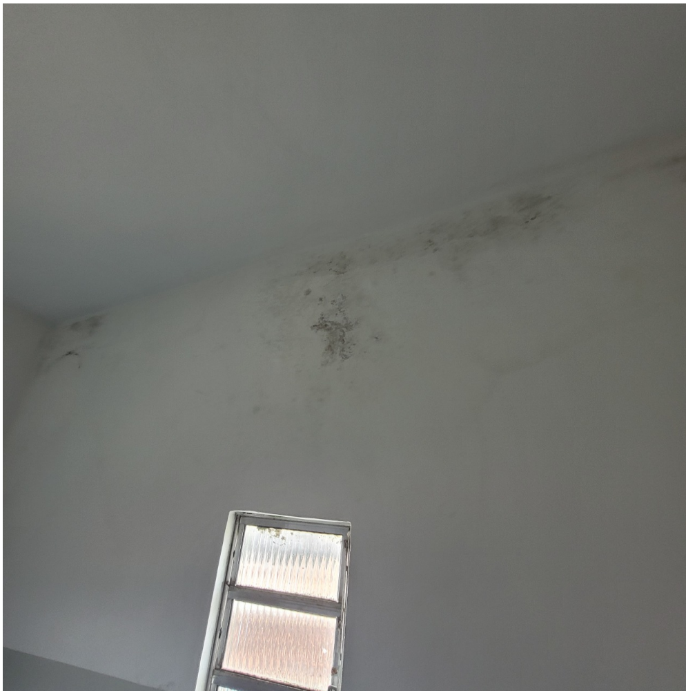
infiltrações e mofo na sala de curativo
