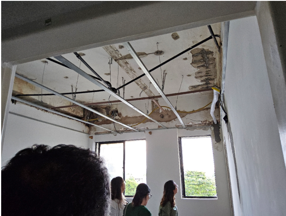
Imagem da 4ª constatação.
