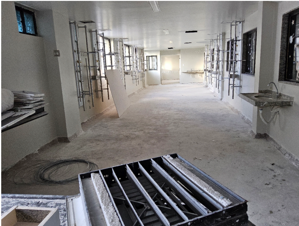
Imagem da 2ª constatação.
