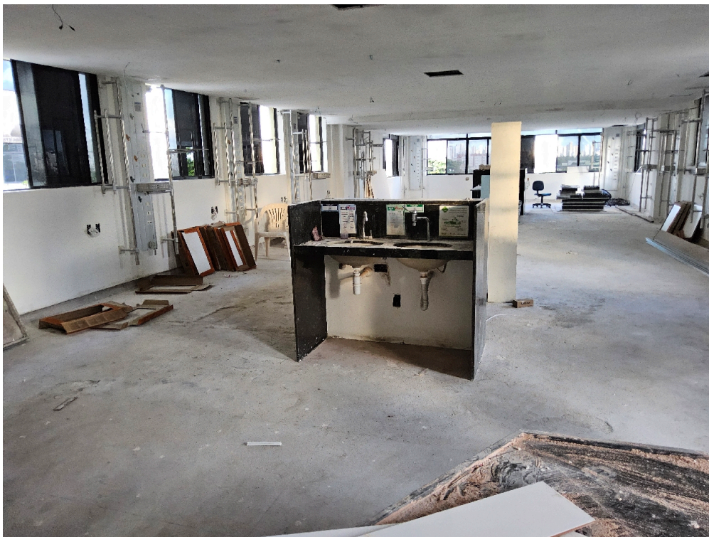
Imagem da 3ª constatação.
