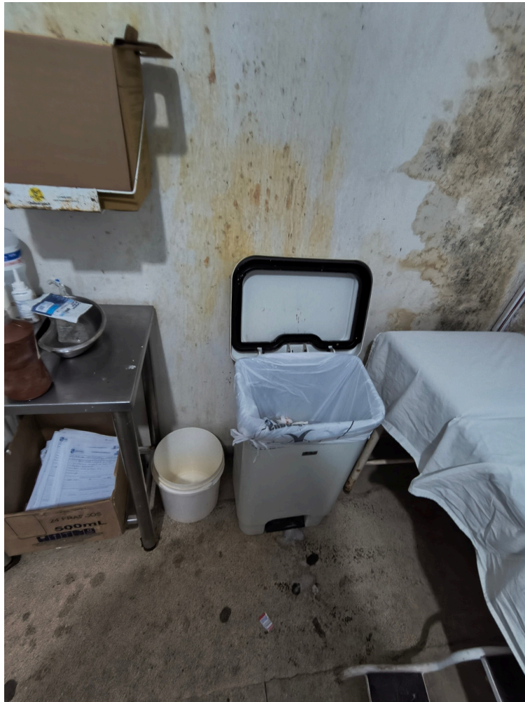
Sala de medicações da urgência com infiltrações e mofo
