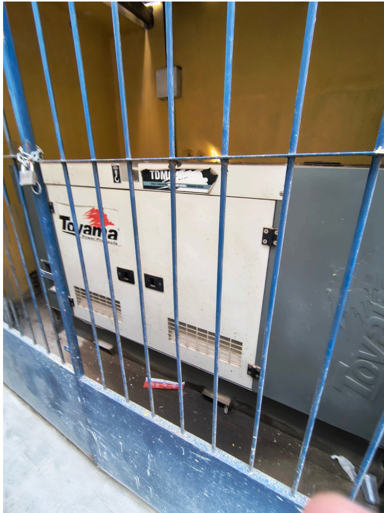
Gerador elétrico cobre toda a unidade no caso de falta de energia
