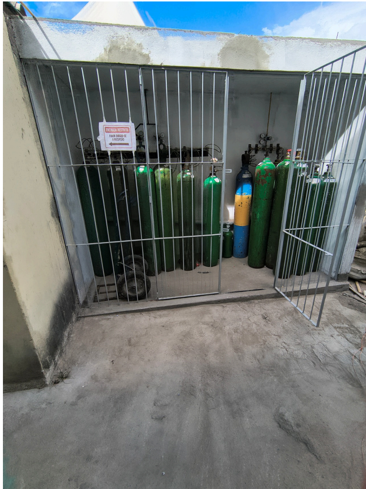
Depósito de cilindros de oxigênio
