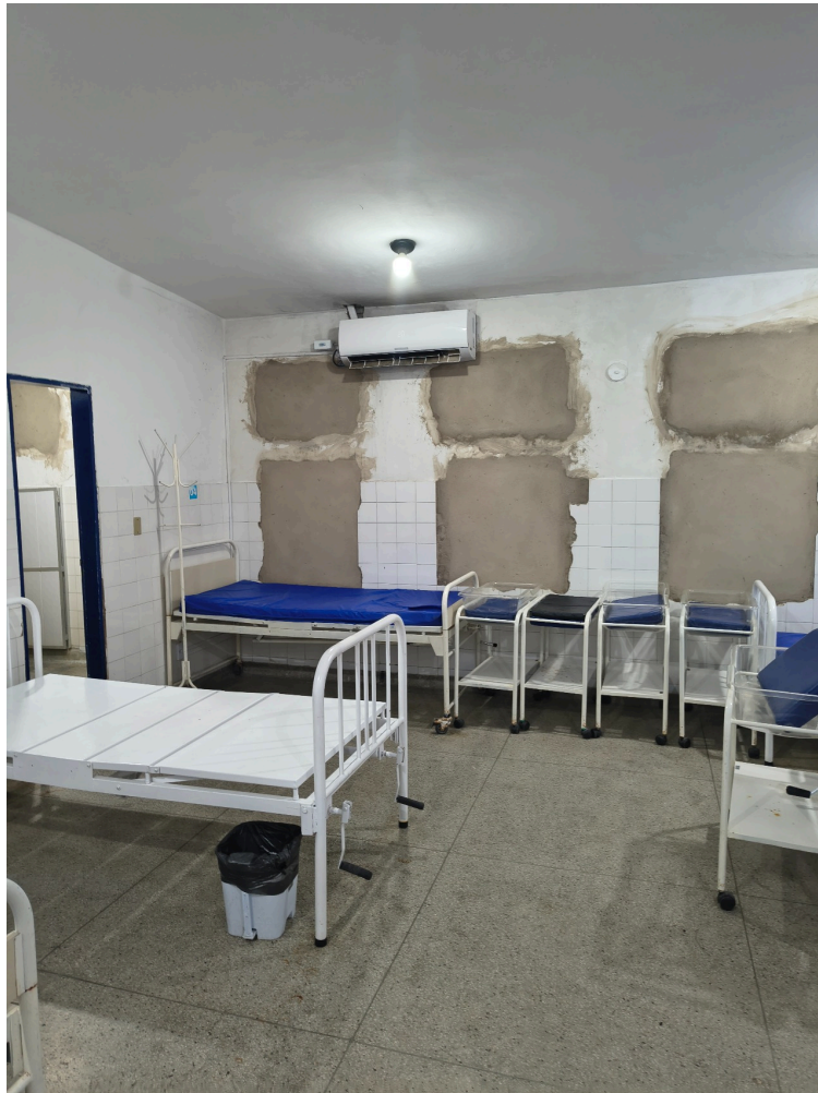
Enfermaria de Obstetrícia estava sem pacientes, com vários pontos de reforma em alvenaria, sem pintura
