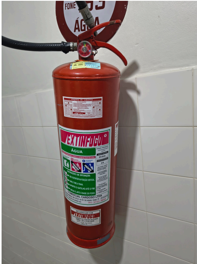
Extintor vencido e sem Alvará de Prevenção e Combate a Incêndios – Bombeiros
