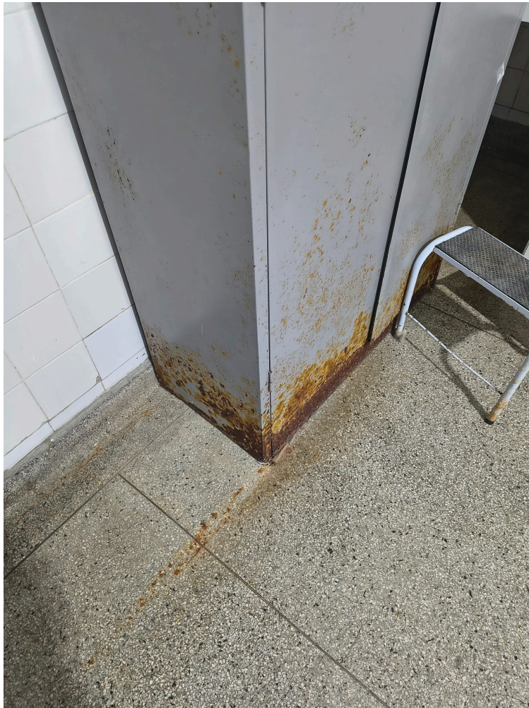
Armário enferrujado dentro da central de material esterilizados - CME
