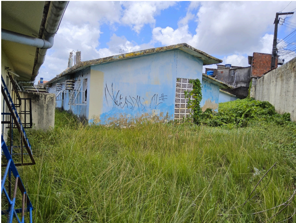
Imagem da 3ª constatação.
