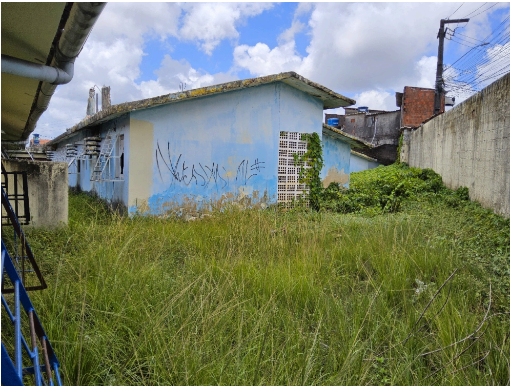
Imagem da 3ª constatação.
