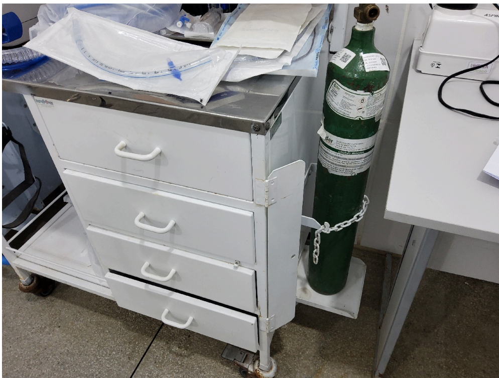
SALA DE REANIMAÇÃO E ESTABILIZAÇÃO DE PACIENTES GRAVES (SALA DE URGÊNCIA, EMERGÊNCIA OU VERMELHA) – ADULTO - Fixo à parede ou em carrinho apropriado para armazenamento e transporte
