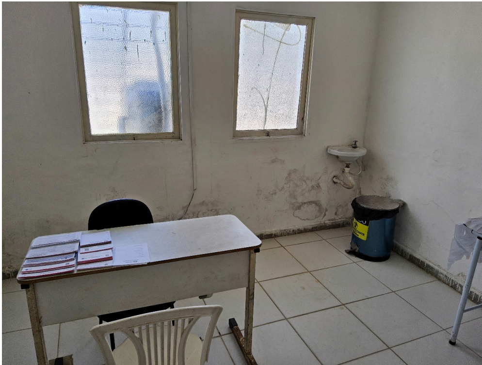
CONDIÇÕES ESTRUTURAIS DO AMBIENTE FÍSICO - GERAL - Instalações livres de trincas, rachaduras, mofo e/ou infiltrações
