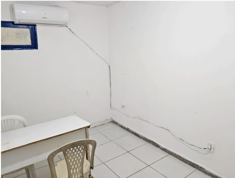
Imagem da 3ª constatação.
