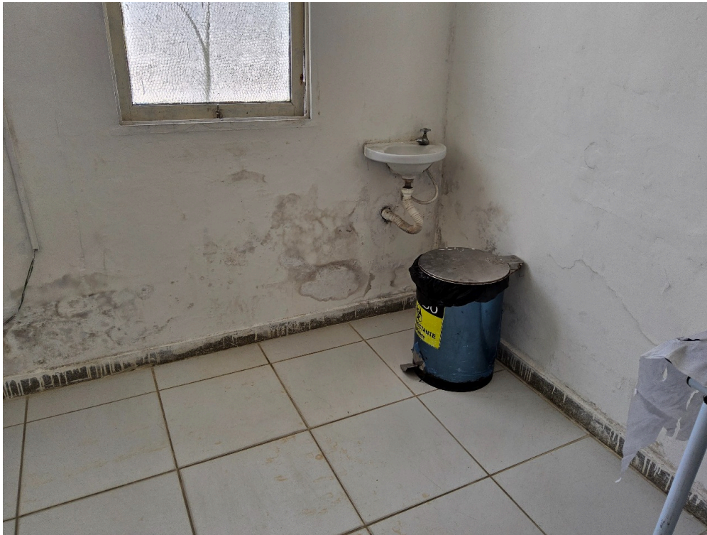
CONDIÇÕES ESTRUTURAIS DO AMBIENTE FÍSICO - GERAL - Instalações livres de trincas, rachaduras, mofos e/ou infiltrações
