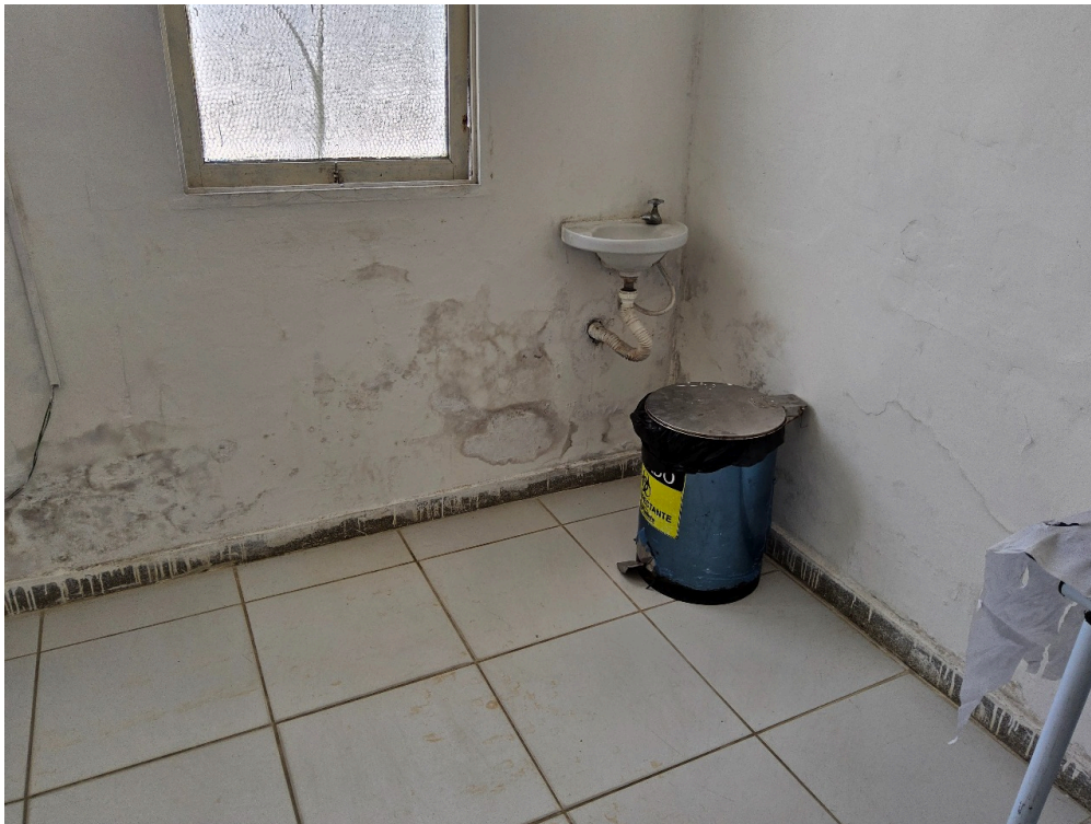
Imagem da 3ª constatação.
