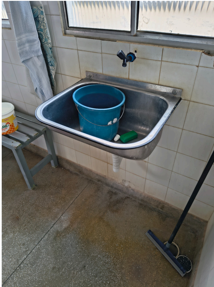
tanque em lavanderia com características domésticas, em ambiente que não é climatizado
