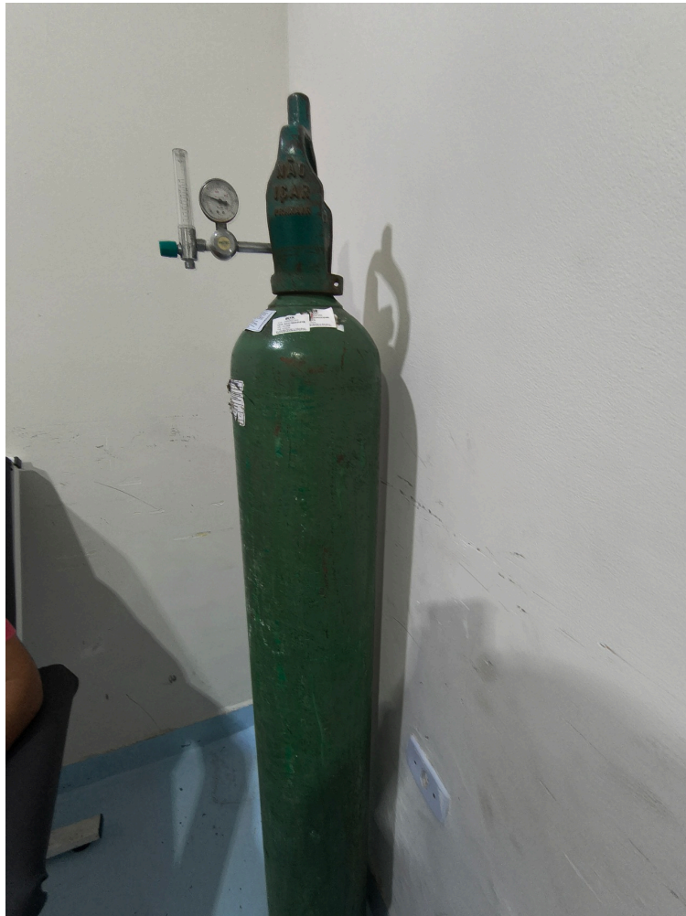
cilindro de oxigênio sem fixação na sala de observação
