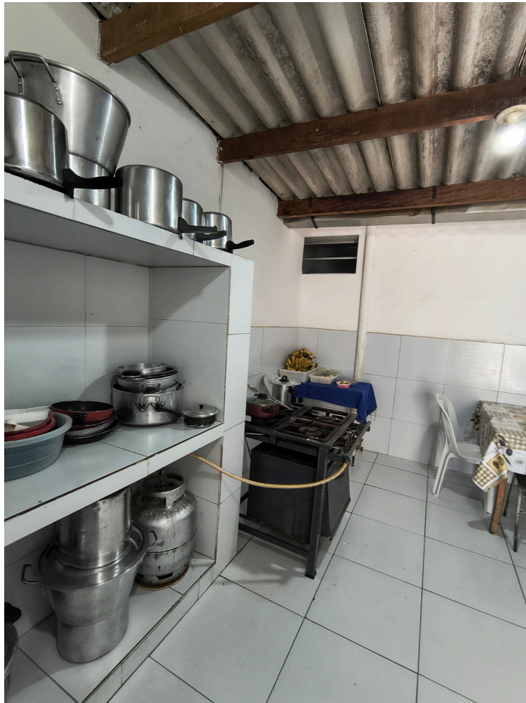
copa\ cozinha com teto sem forro, mal aerada, abafada
