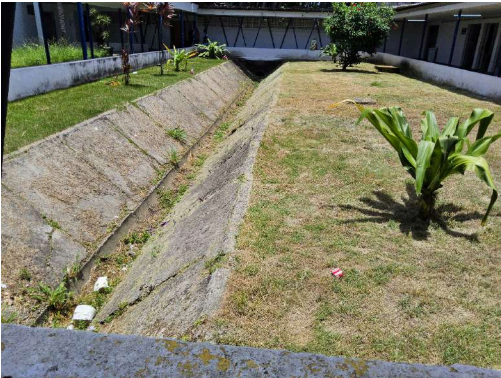
Imagem da 5ª constatação.
