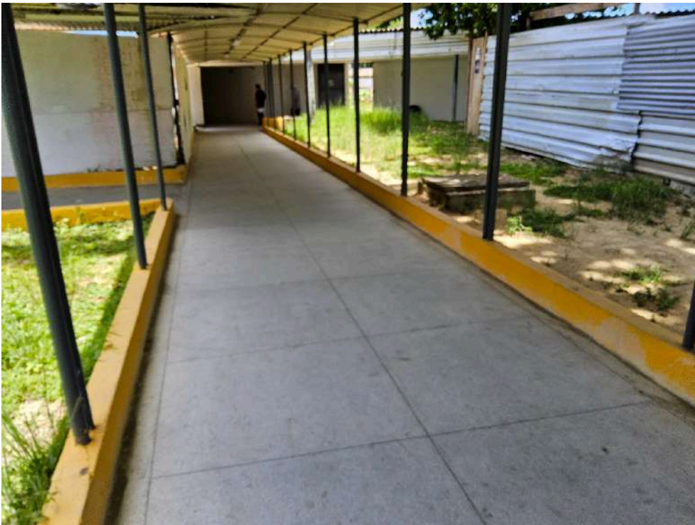
Imagem da 5ª constatação.
