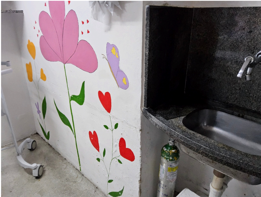
EMERGÊNCIA (SALA VERMELHA) - observar cilindro sem fixação
