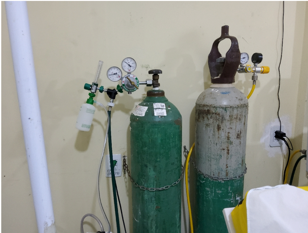
SALA DE REANIMAÇÃO E ESTABILIZAÇÃO DE PACIENTES GRAVES (SALA DE URGÊNCIA, EMERGÊNCIA OU VERMELHA) – cilindro fixo à parede
