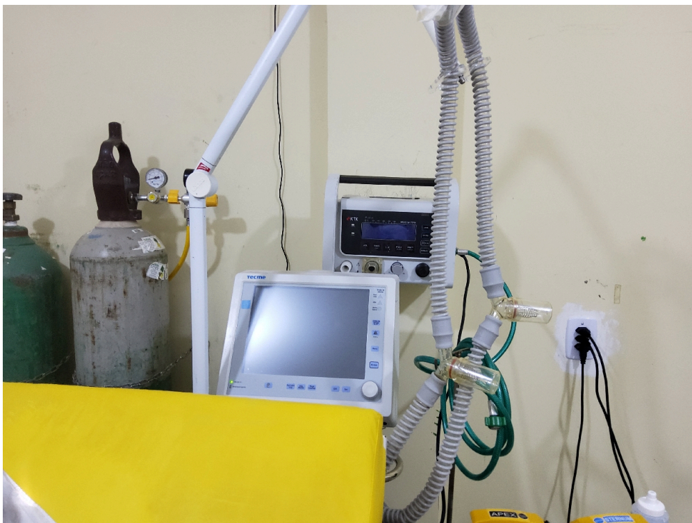
SALA DE REANIMAÇÃO E ESTABILIZAÇÃO DE PACIENTES GRAVES (SALA DE URGÊNCIA, EMERGÊNCIA OU VERMELHA) – respiradores
