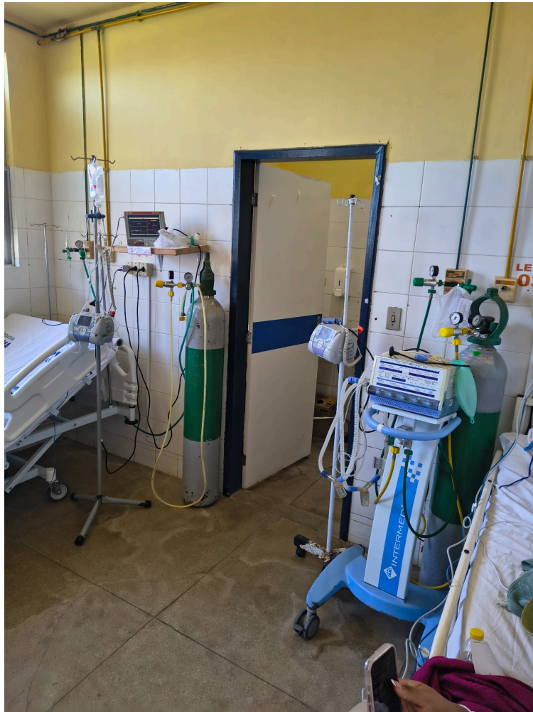
SALA DE OBSERVAÇÃO PEDIÁTRICA - Não há acomodação adequada para acompanhantes. Destacando cilindro não fixado.
