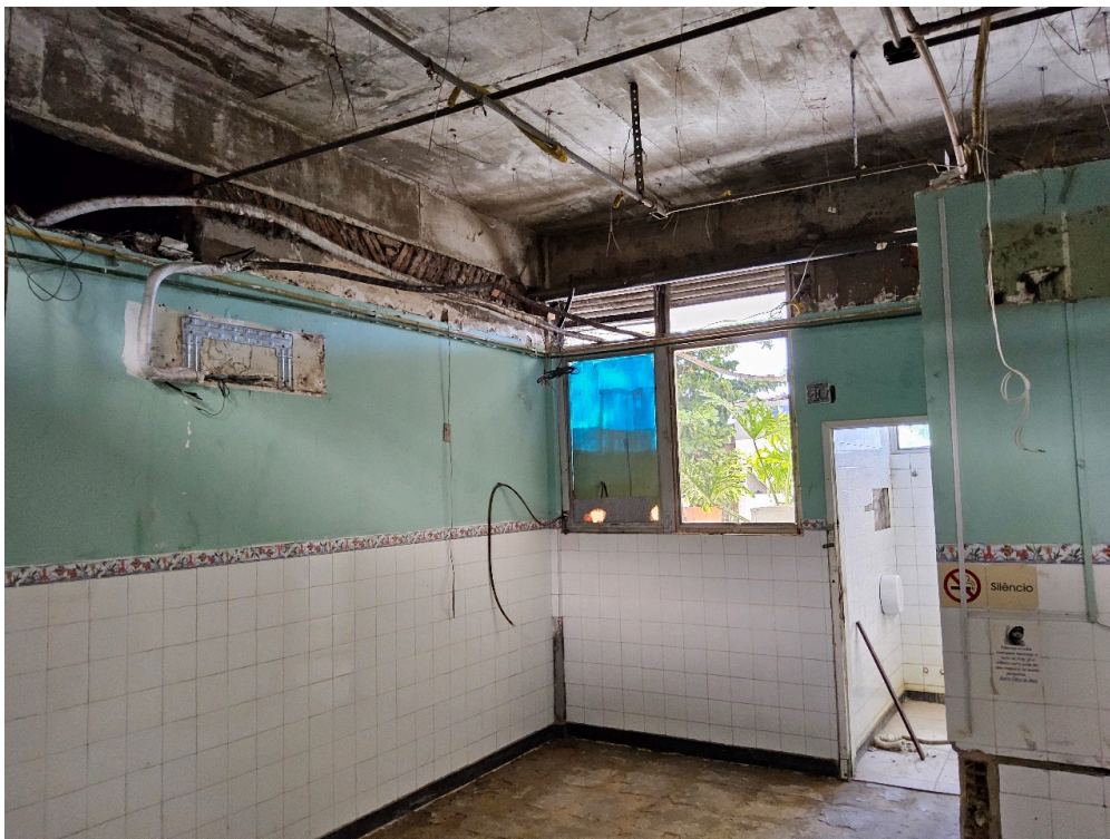
CONDIÇÕES ESTRUTURAIS DO AMBIENTE FÍSICO - GERAL - A estrutura física da unidade não está livre de graves ameaças à segurança do paciente e/ou do ato médico - Emergência pediátrica em reforma
