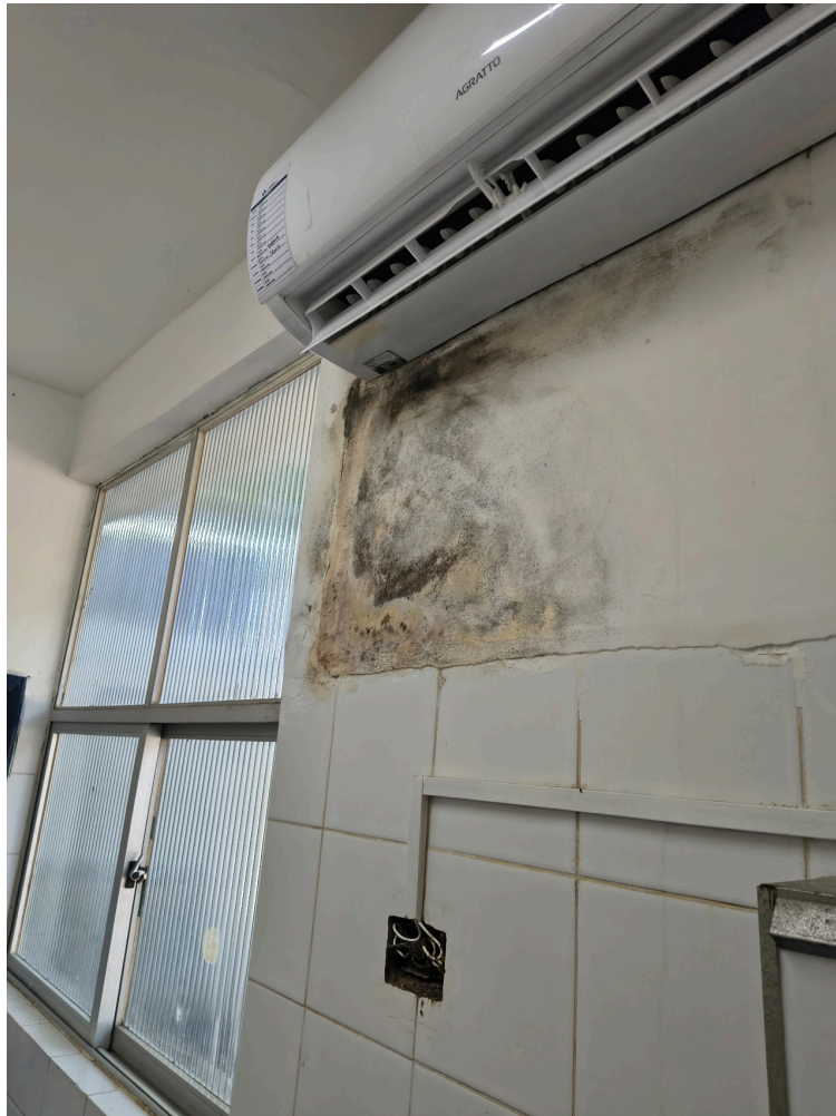
Consultório PEDIATRIA - Infiltração e mofo.
