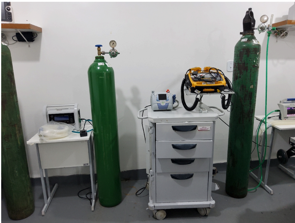
SALA DE REANIMAÇÃO E ESTABILIZAÇÃO DE PACIENTES GRAVES (SALA DE URGÊNCIA, EMERGÊNCIA OU VERMELHA) - observar cilindros de oxigênio sem fixação
