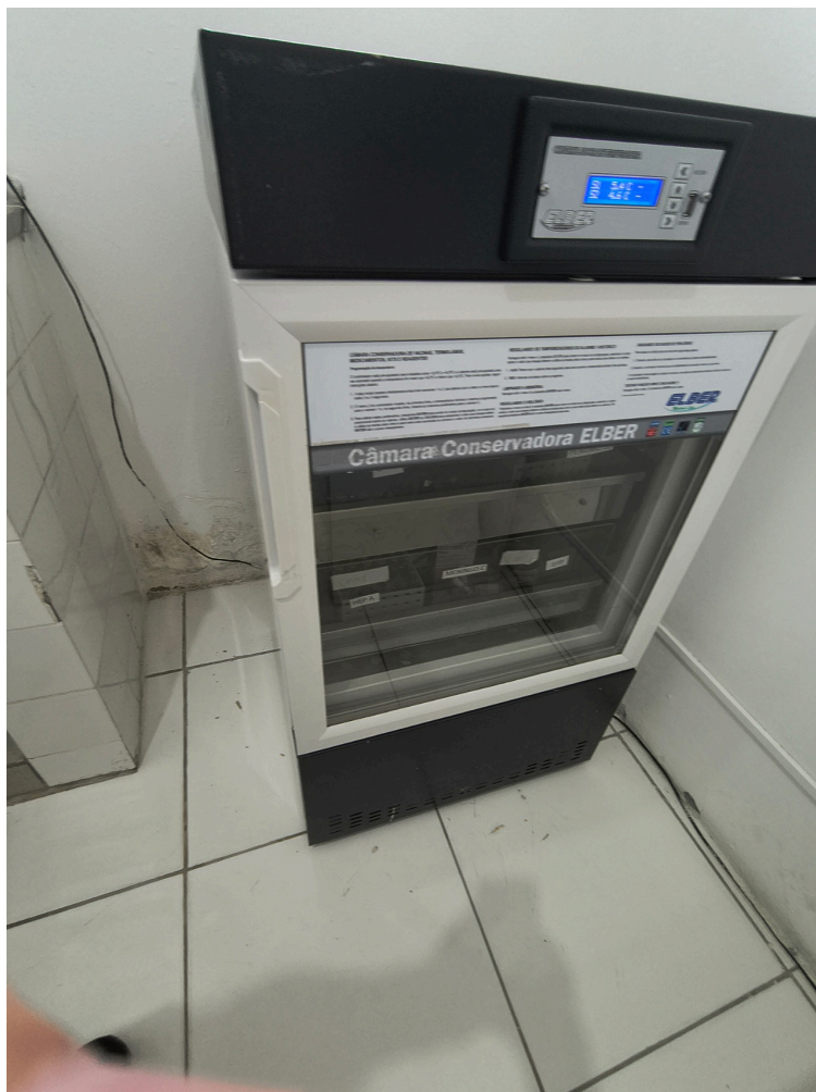
câmara fria na sala de vacinas
