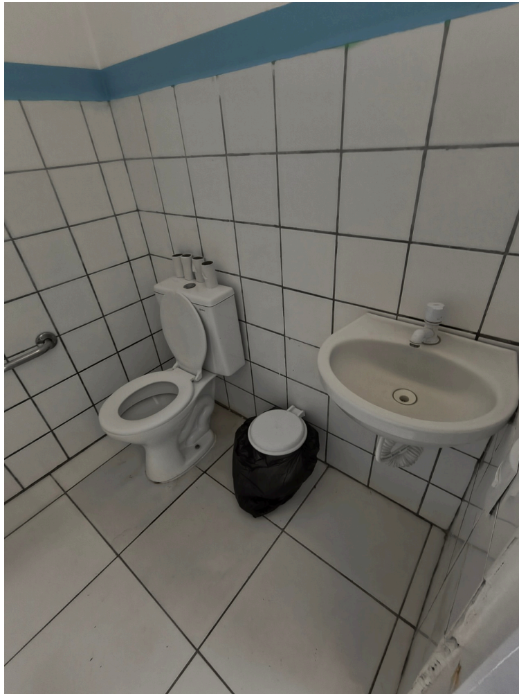
banheiro único para os usuários sem sinalização
